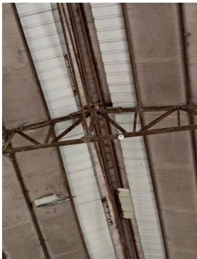
附图 6.3-19 仓库内火焰探测器已设置于顶部
