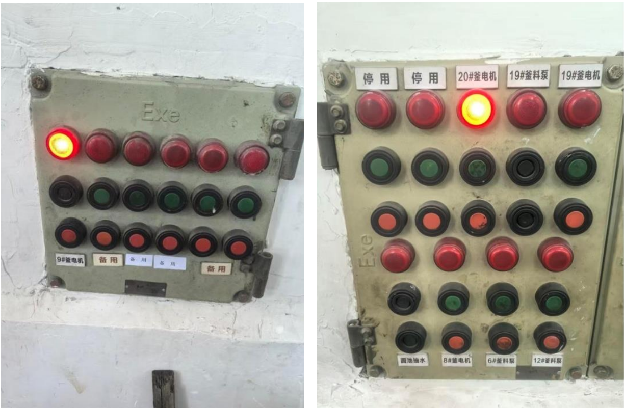
附图 6.3-9 已更正车间内反应釜的操作按钮标识牌
