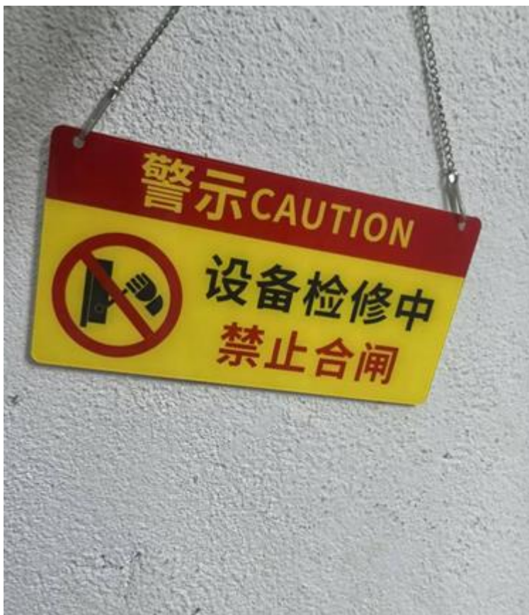
附图 6.1-4 配电室已增配检修操作所需的警示标志牌
