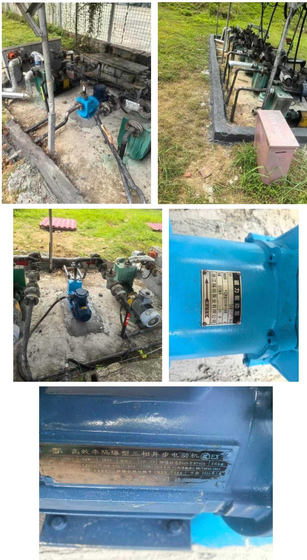
附图 6.3-10 罐区发料泵区域已增设围堰，已将甲苯输送泵更换为无泄漏泵
