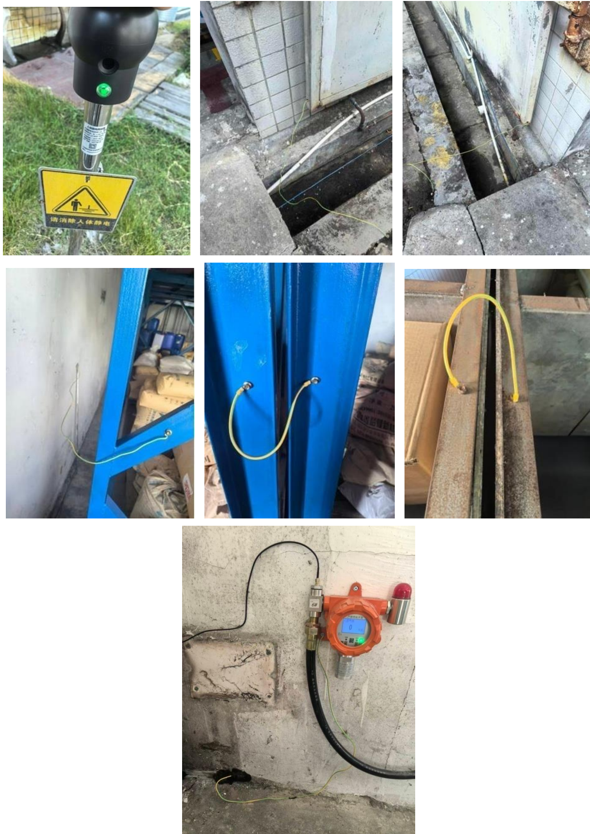
附图 6.3-5 已修复甲类仓库入口处失效的静电释放器，库内金属货架已采取接地措施，钢制门、可燃气体报警器均已采取接地措施
