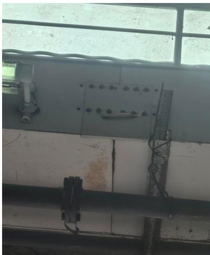
附图 6.3-14 生产车间内的桥架已增设静电跨接措施
