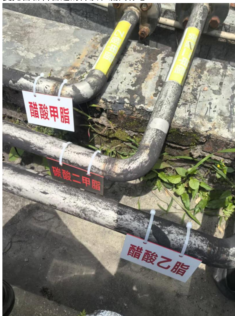
附图 6.1-3 已修复完善物料管道的介质和流向标志
