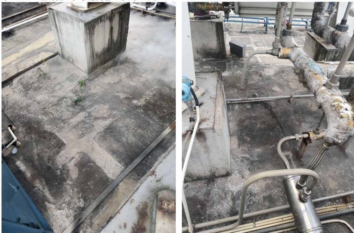
附图 6.3-5 已清洗干净液氧贮罐的地面
