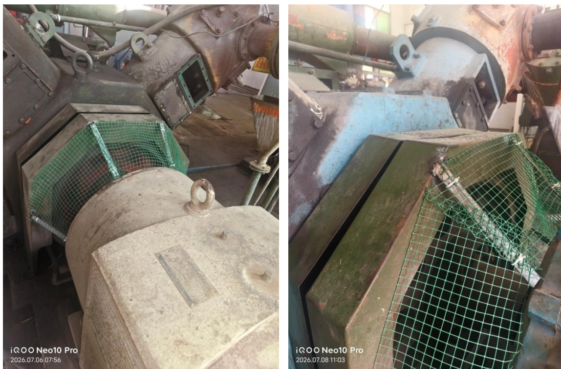
附图 6.3-9 已在空分车间压缩机转动轴处增设防护措施
